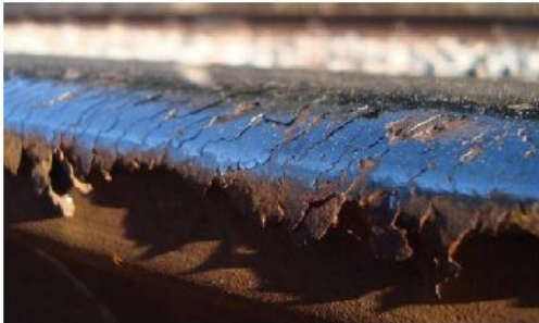
Fig. 9. Sina cu defect
