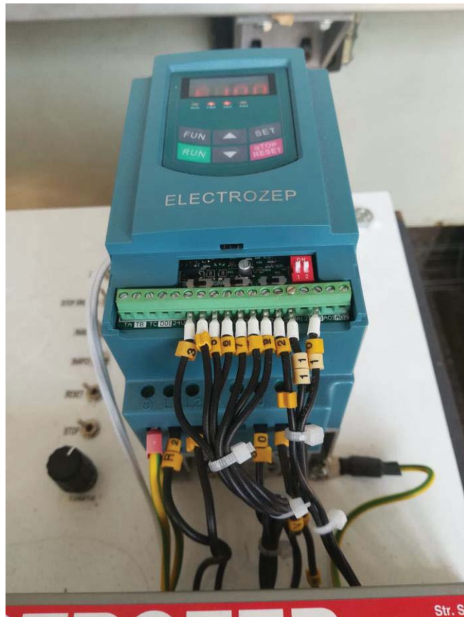
Fig.7 Convertizorul de frecventa
