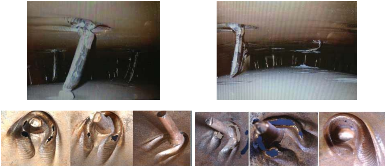
Fig. 2. Eroziune ajunsă pâna la găurirea tablei.
