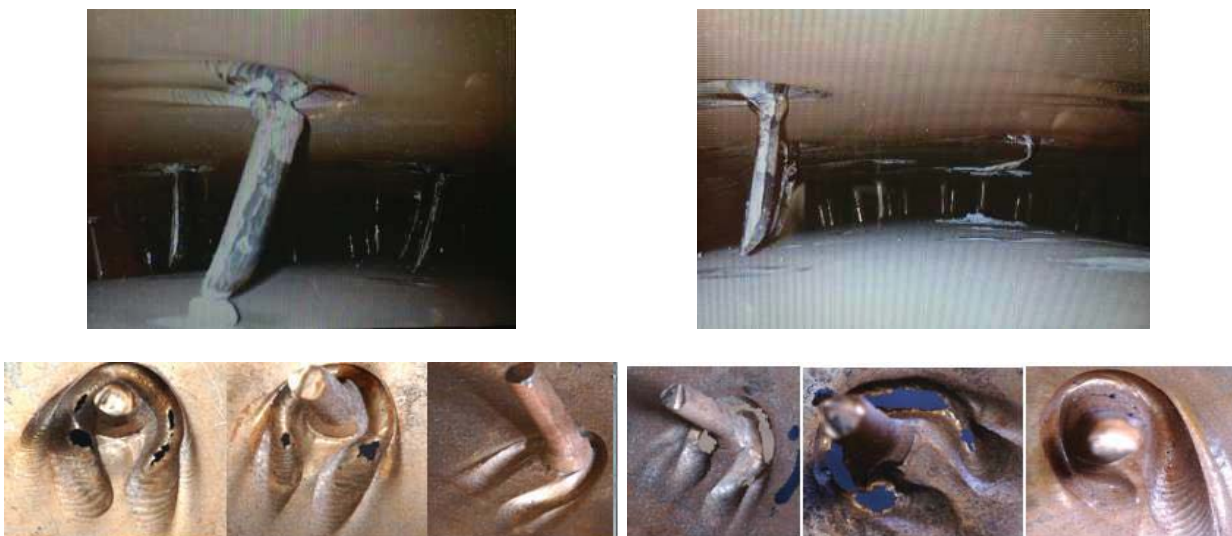
Fig. 2. Eroziune ajunsă pâna la găurirea tablei.
