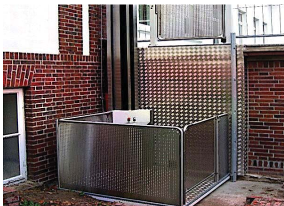
Fig.2 Lift exterior pentru aprovizionare [7]
