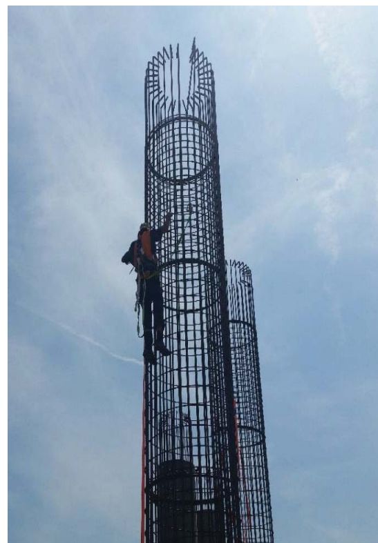
Fig. 11. Armarea carcasei stalpului
