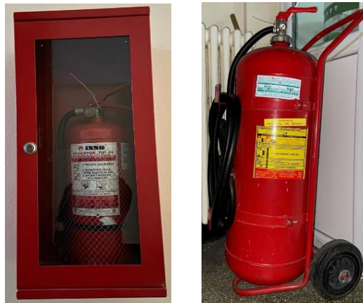
Fig. 3. Stingătoare de incendiu
